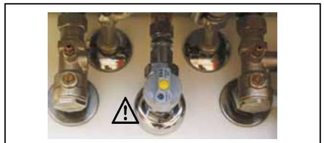
Ábra: gázcsatlakozás: a kiáramló gáz mérgezést, robbanást
