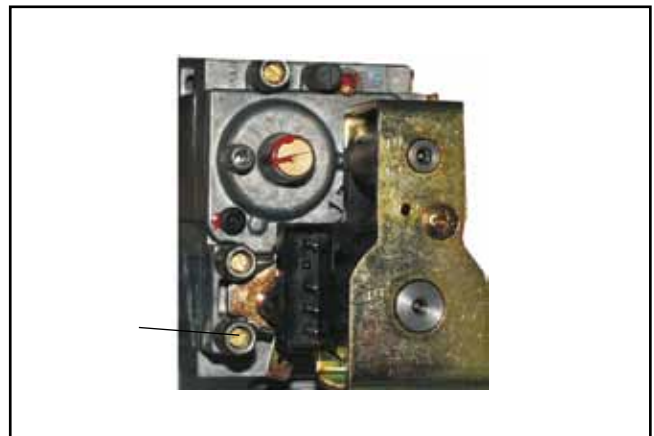
Ábra: a csatlakozási gáznyomás ellenőrzésre
